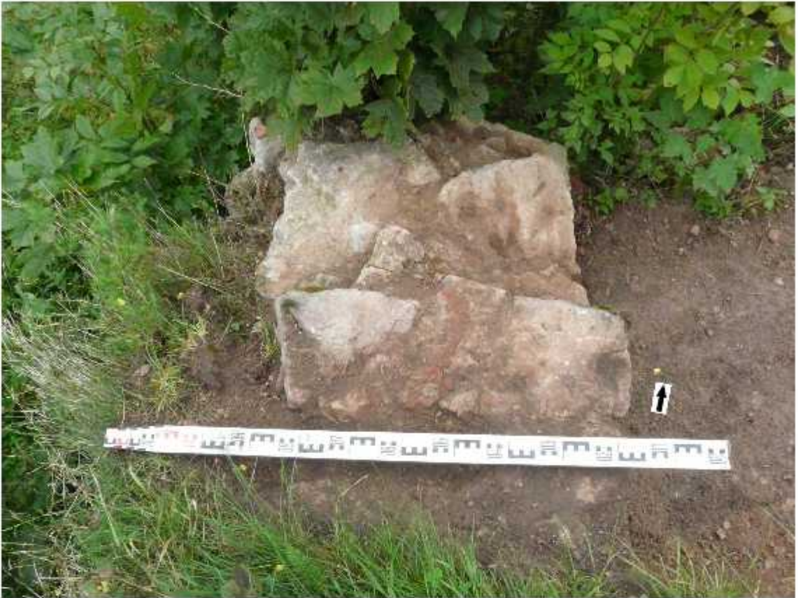
Fot. 29. Bodzentyn, zamek, teren pałacu biskupów krakowskich. Wykop 1/2019, odcinek I, część zachodnia. Korona muru D. Widok od S.
